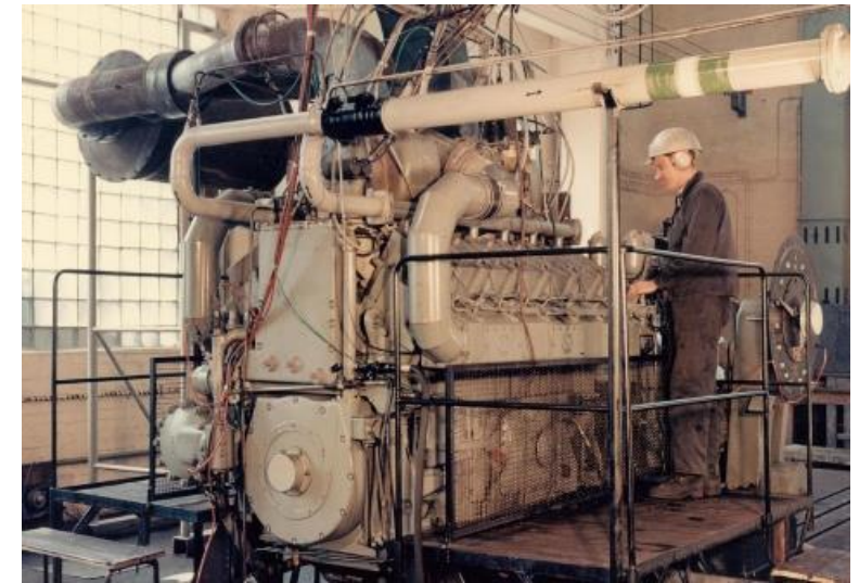
12 KVD 21 auf Prüfstand, Quelle: Archiv WTZ Roßlau
