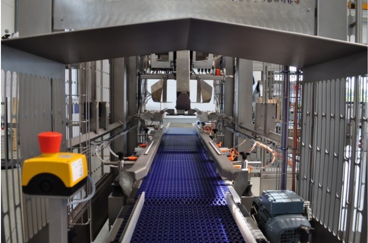
Abb. 7.2 Trennende Schutzeinrichtungen und Not-Halt-Einrichtungen an der Verpackungsanlage
