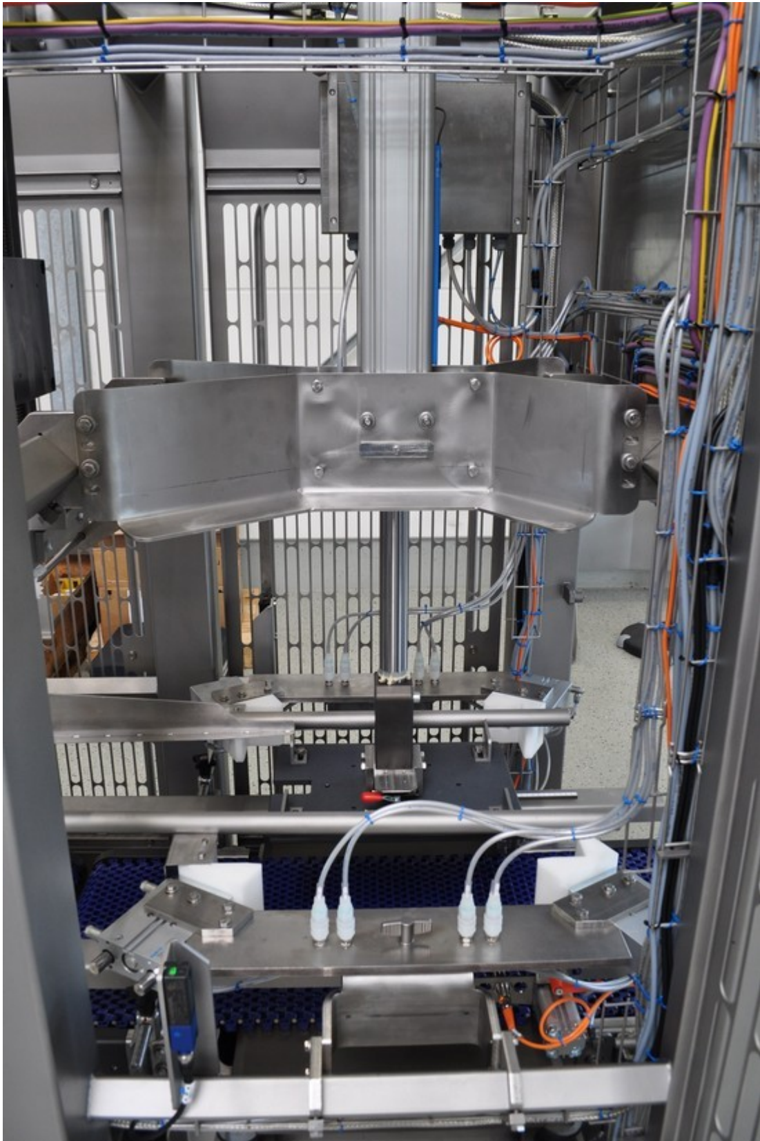
Verpackungsanlage - Andrück- und Rüttelstation
