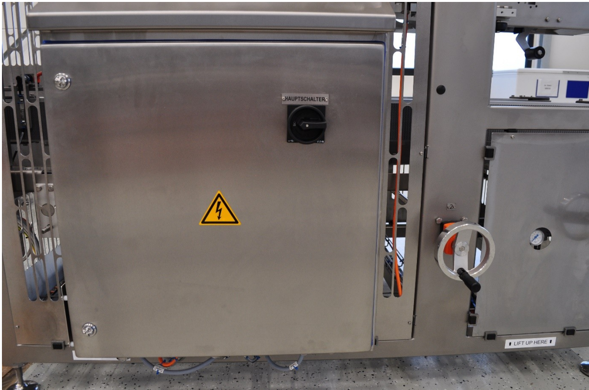
Abb. 6.2 Verschließbarer Schaltschrank mit Warnhinweis
