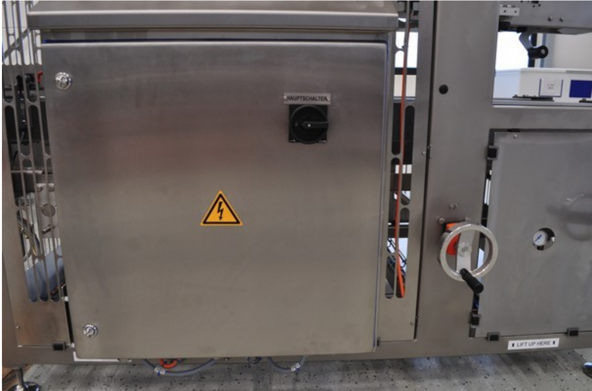
Abb. 4.2 Schaltschrank der Verpackungsanlage
