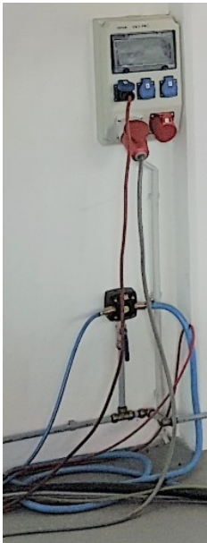
Abb. 3.4 Anschlüsse des Industrieroboters an die Medienversorgung
