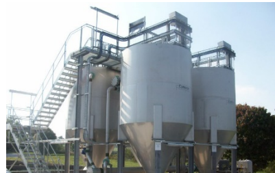
Sandfilter für Industrieabwässer [4]
