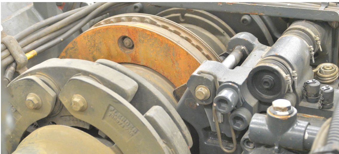
Abbildung 5.36: Eingebaute Bremscheibe in einem Straßenbahnfahrwerk. Die Bildung einer reibwertverändernden Zwischenschicht (Flugrost) ist deutlich erkennbar.
