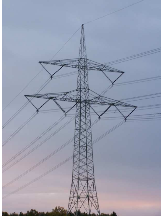
380-kV-Mast (Donaumast) - Höhe 50 m
