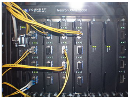
Router mit XFP-Modulen und angeschlossenen Monomodefasern (OS1/2 – gelb) mit LC-Steckern.
