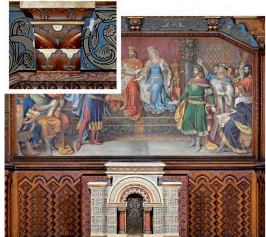
Abb. 6. Schloss Neuschwanstein, Arbeitszimmer, Orthofoto im Originalmaßstab 1:10 sowie Ausschnittsvergrößerung (Putzschäden).
